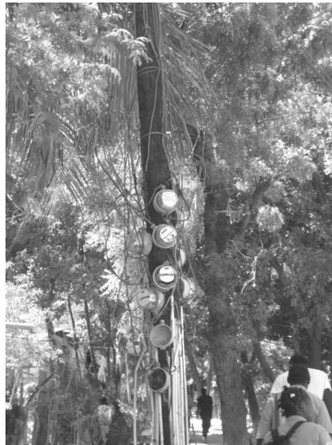
Compteurs électriques pirates, poncif du paysage urbain port-au-princien, Haïti, janvier 2008
